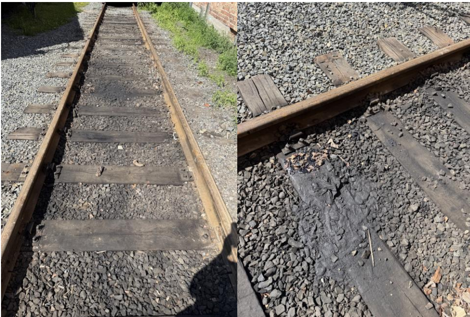
Figur 15: Fotografi från provtagningen på uppställningsspåret som visar på misstänkt spill av kemikalier. Foto från 2025-07-08.
